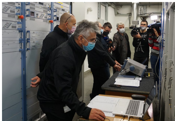
Fotografija: Prvo uključivanje novog DVB-T2 sustava na objektu Belje
